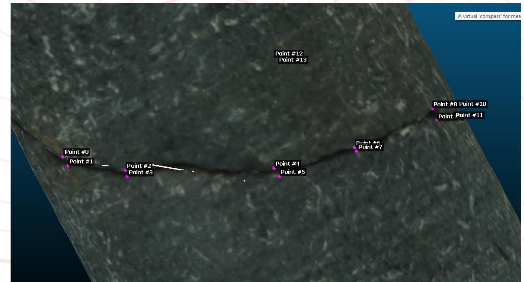
Obr. 8 – příklad měření šířky trhliny
